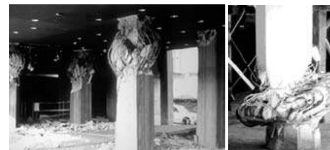
Fotografia 2.5 – Pilares fendilhados por efeitos sísmicos.
