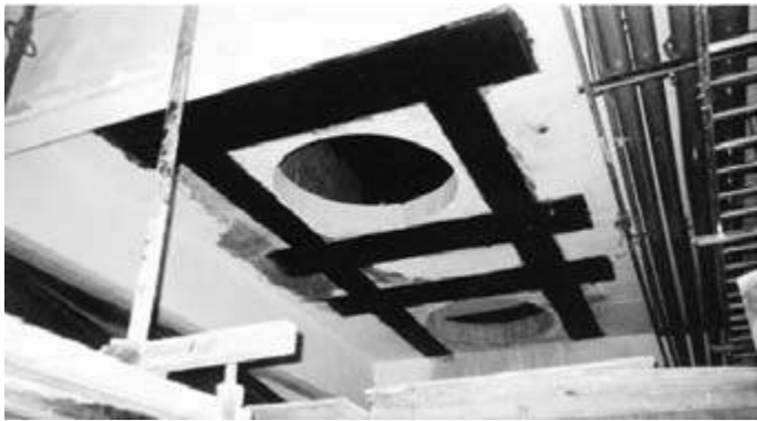
Fotografia 9.3 – Reforço para permitir a execução de furos para instalação de novos equipamentos industriais.
